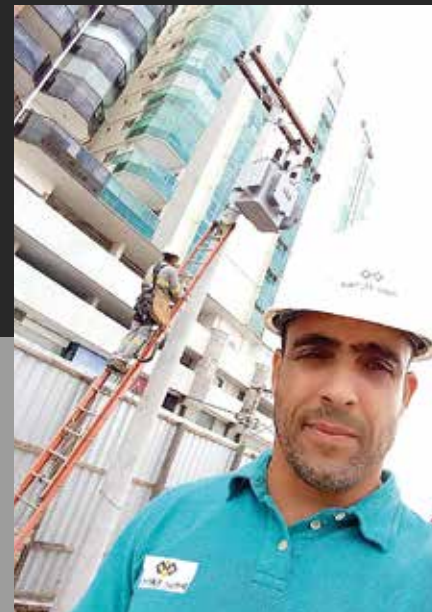
Yousseff Nasser, Diretor Pritec Elétrica Engenharia e Serviços
